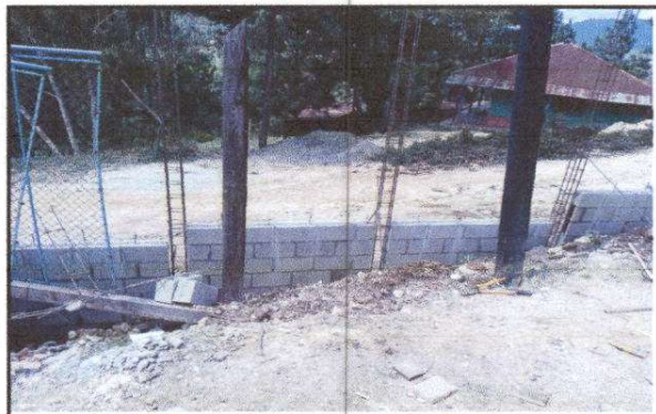
Foto 4: Circulación en mal estado, malla rota y tubo doblado.
