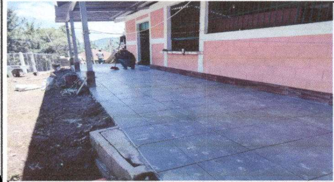
Foto 1: Torta de cemento en mal estado
