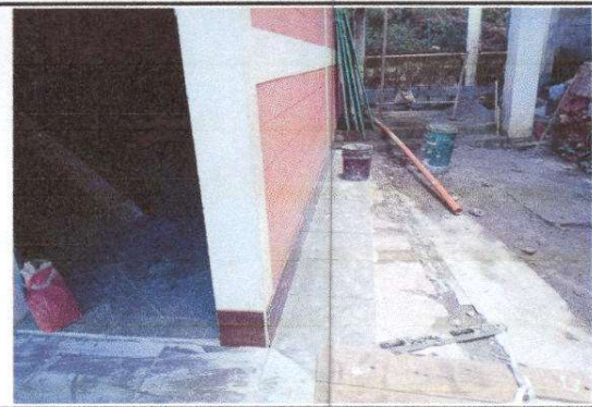
Foto 2: Torta de cemento en mal estado
